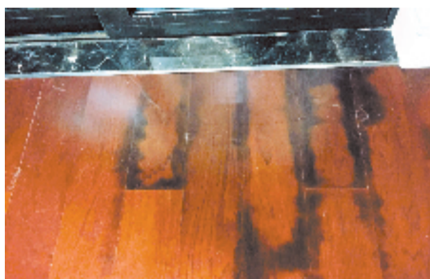
刚交付楼盘的地板渗水(图文无关)
