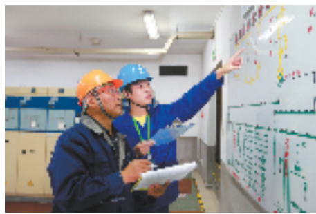
国网杭州市萧山区供电公司运维人员向客户讲解设备自动化改造方案 李俊/摄
