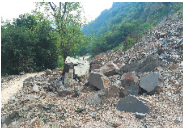
白章线塌方现场
