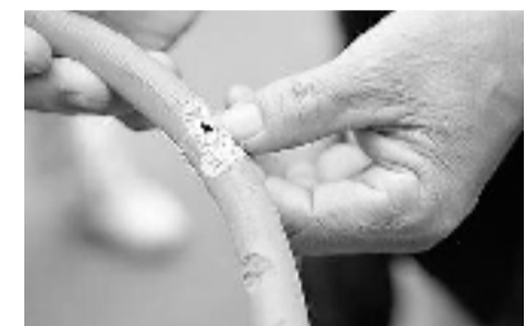
上图:橡胶软管被老鼠咬破,会引起天然气泄漏。
