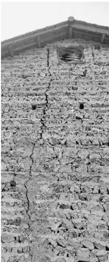
中间桥村受损房屋
