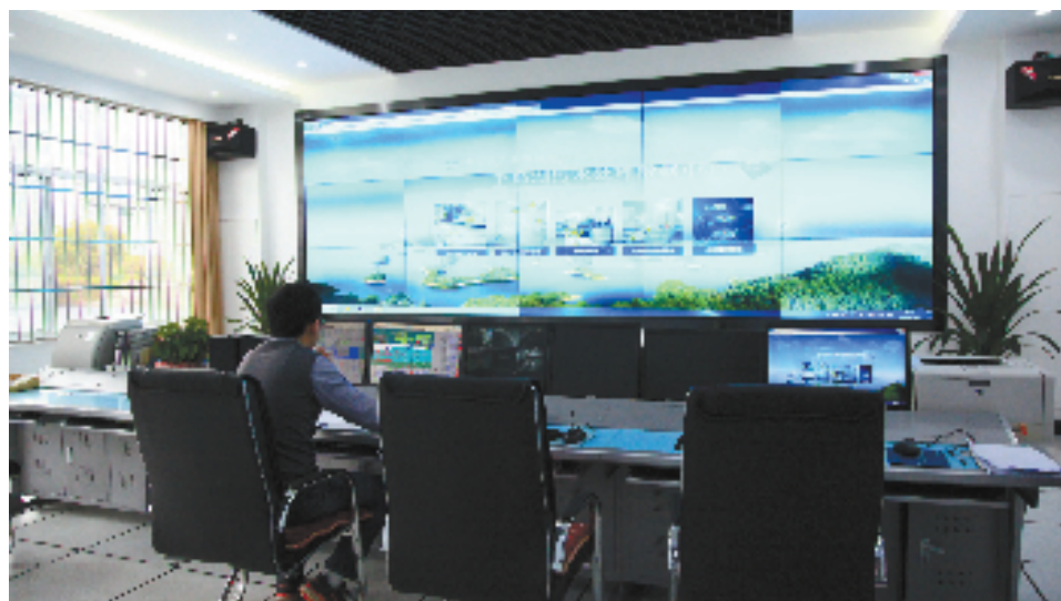
污水处理数据监控中心
