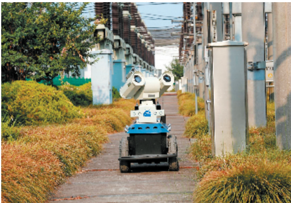
高温下,智能巡检机器人对变电站设备进行巡检 李俊摄
