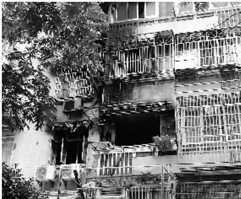
远远就能看到朝晖七区38幢2单元3楼至6楼的窗口和墙壁都烧焦了。
