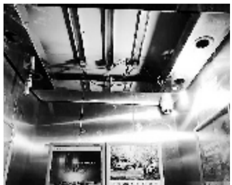
电梯吊顶掉落,电梯顶部的情景。
