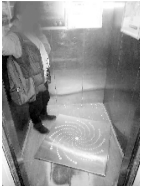
电梯吊顶砸下时的情形。
