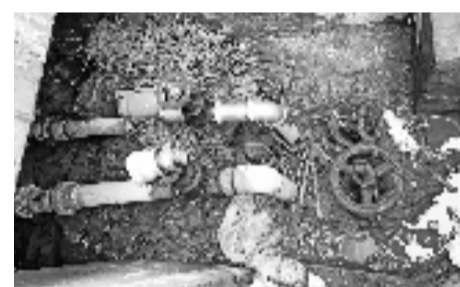
图为冻裂的水管。
