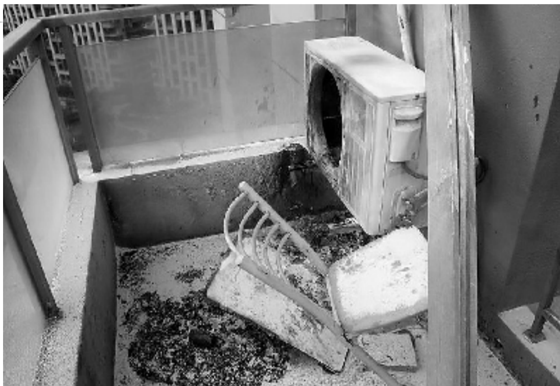
空调外机起火,被烧得只剩下空架子
