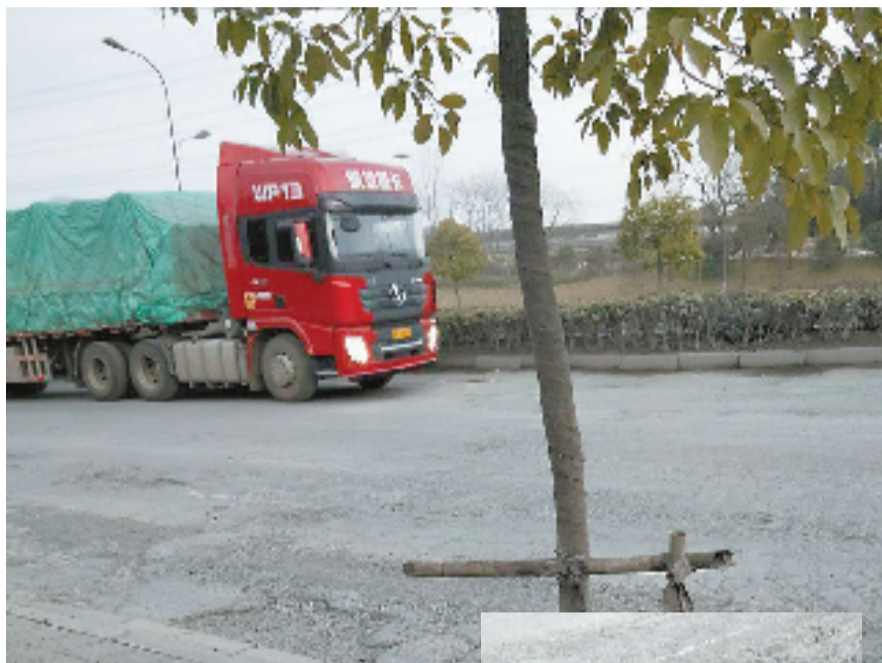
道路路面破损严重
