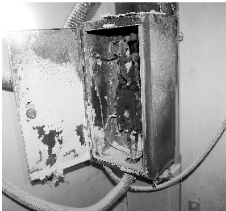
楼道电表箱起火,外壳被烧得漆黑
