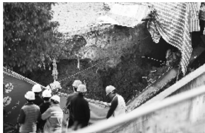
昨日的坍塌现场。视觉中国供图
