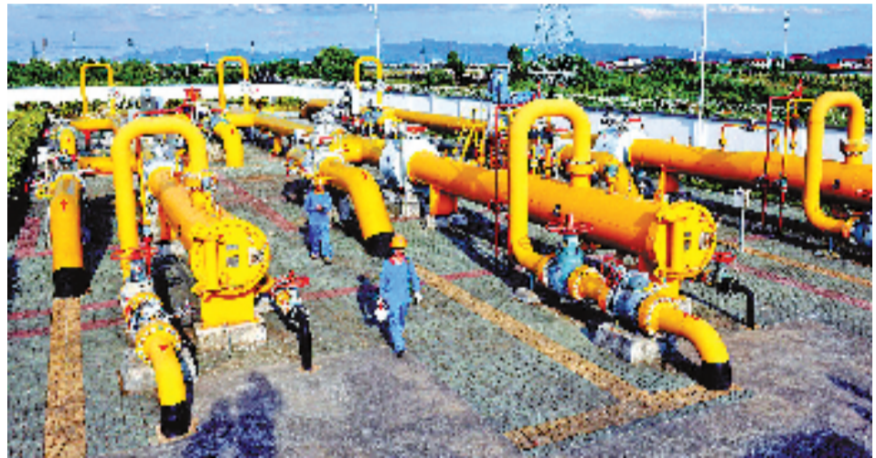
杭衢天然气管道金华中心站。朱将云 摄
