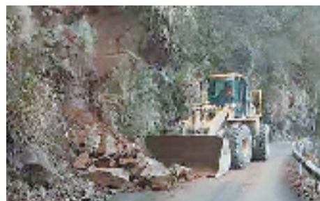
地点:大罗线K20+200 塌方面积:32m 2
