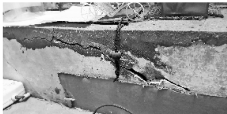
外墙裂缝随处可见。
