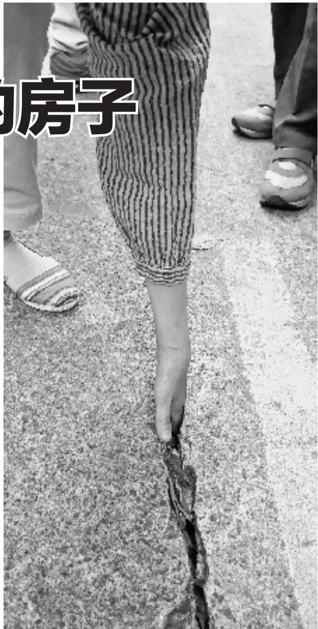
成年人手掌轻松探入地面沉降的裂缝。
