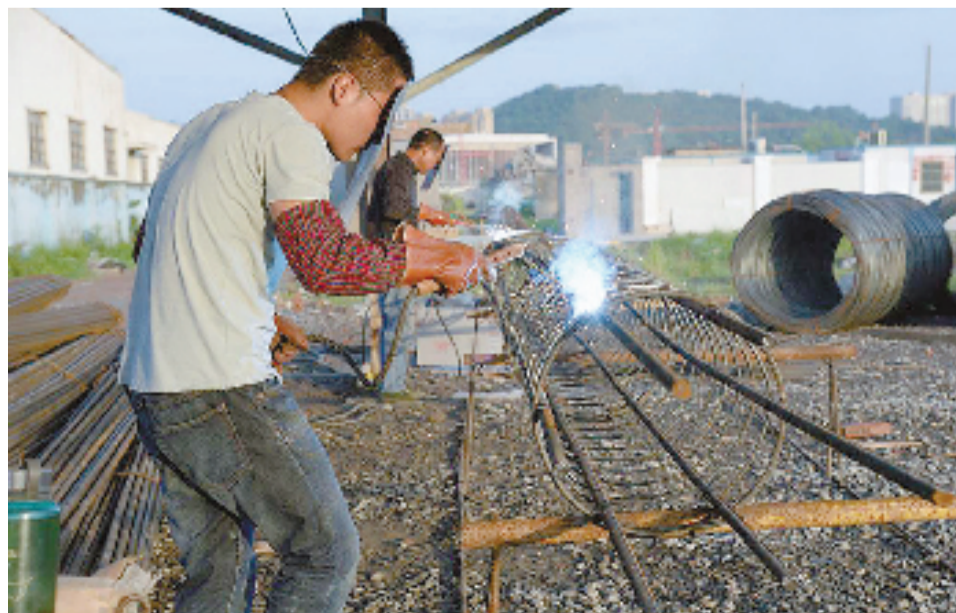
8月12日,台风利奇马刚走,高温卷土重来。在杭州火车站东广场只见电焊工师傅,挥汗如雨,奋战高温。傅灿良 摄
