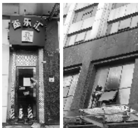
出事的棋牌房,墙体熏黑,玻璃破裂
