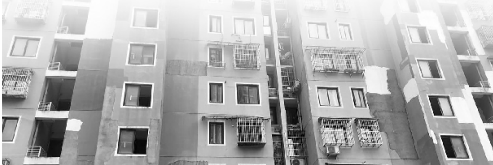
8幢外墙脱落严重
