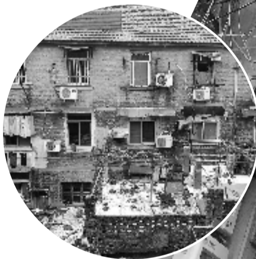
这几幢房屋都破败不堪,渗漏严重
