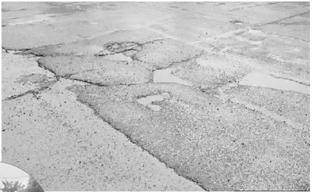
破损路面约4公里
