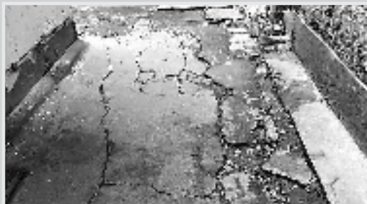
门口的地面已经破损
