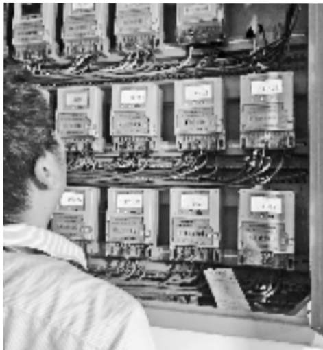
工作人员对电表进行初步检查
