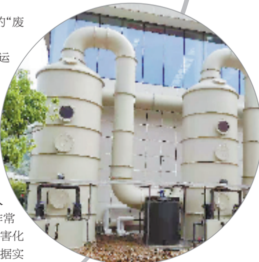
将蓝餐厨废弃物处理有限公司废弃物除臭设备
