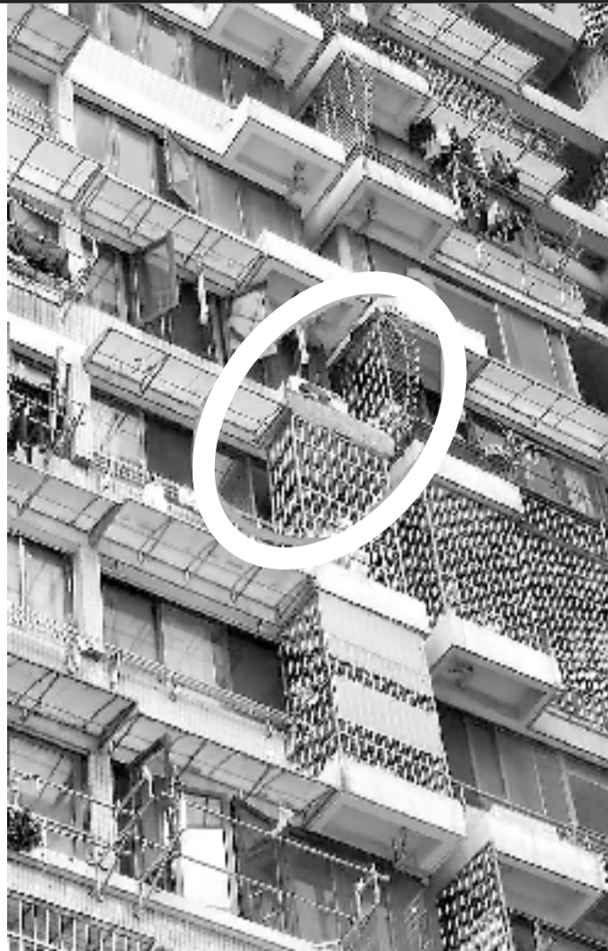
空调外机放置台外侧部分水泥外墙脱落
