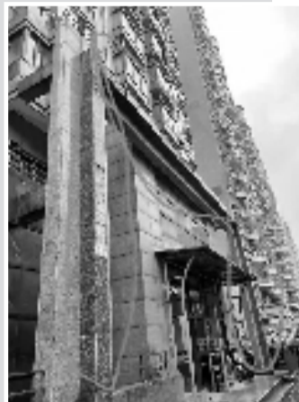
莱茵园楼幢外立面，贴的砖已掉落
