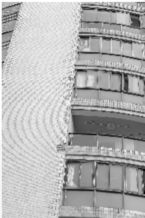
莱茵园楼幢外立面高处的砖已掉落
