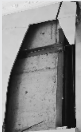
旅馆大理石墙面被震碎
