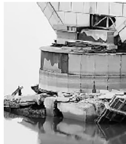
浣水桥桥墩破损 受访者供图
